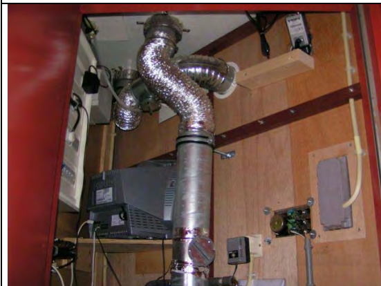
De technische ruimte van een iets ander type containercel op Schiphol Oost
